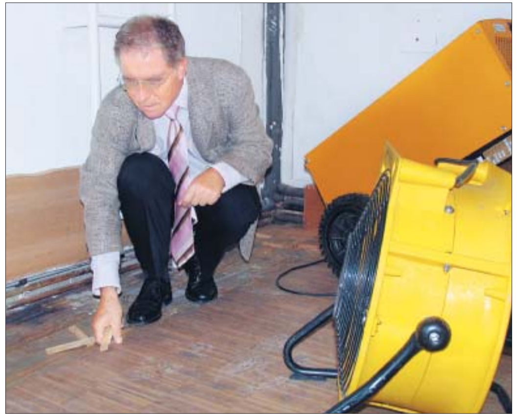
Analyse: Bauhof-Chef Klaus Grupe prüft, was die Trockengeräte bisher geleistet haben. Das ausgetretene Wasser hatte sich unter dem Parkettboden ausgebreitet und diesen schließlich hochgedrückt. Zottl
